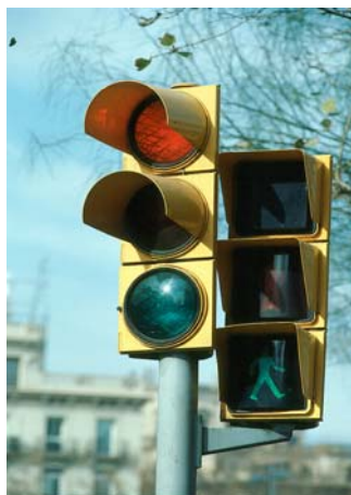
Exemple de semàfor amb mòdul acústic
